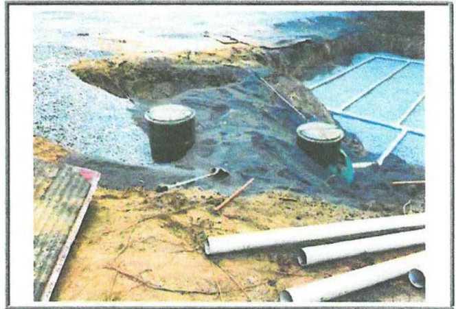
Identification : Fosse septique
