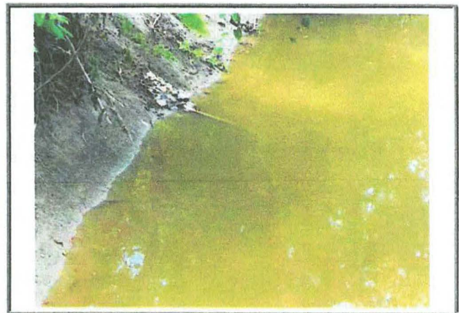
Identification : Conduite émissaire submergée
