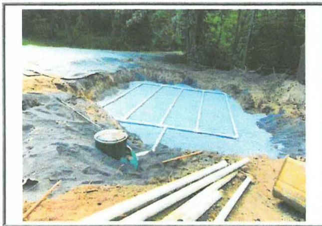
Identification : Filtre à sable classique
