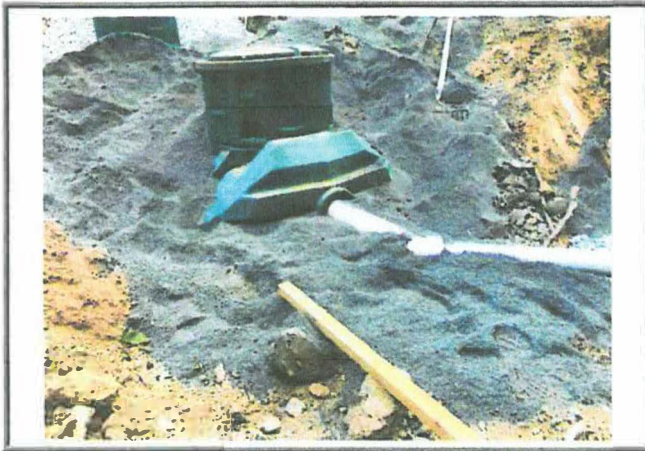
Identification : Fosse septique
